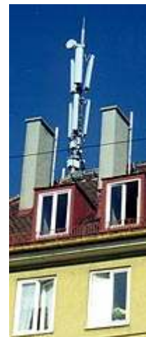
Mobilfunk-Antenne auf dem Hausdach.
